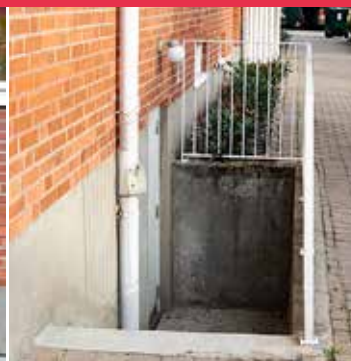
FÖRE: I den gamla trappen leddes vattnet från stupröret direkt till va-ledningar under jord – ledningar som ofta täpps igen eller går sönder av ålder.
